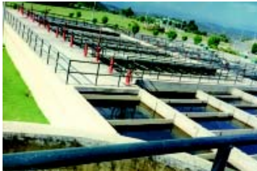
Figura 3-16. Floculador de flujo vertical con pantallas de asbesto-cemento (7)
