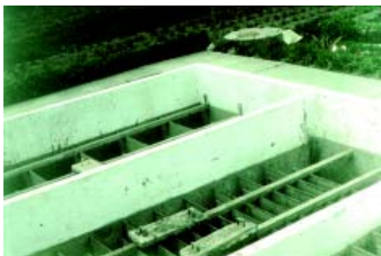
Figura 3-5. Floculador con pantallas de asbesto-cemento planas (7)
