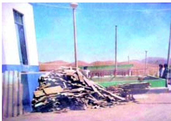
Figura 3-4. Pantallas de asbesto-cemento rotas (7)
