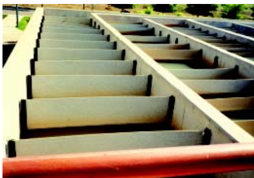
Figura 3-19. Floculador de flujo vertical con pantallas de un centímetro de espesor (7)
